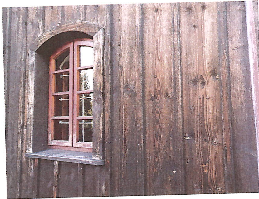
Zdj. 2 Drewniany kościół św. Anny Gołkowice - widok stanu deskowania
